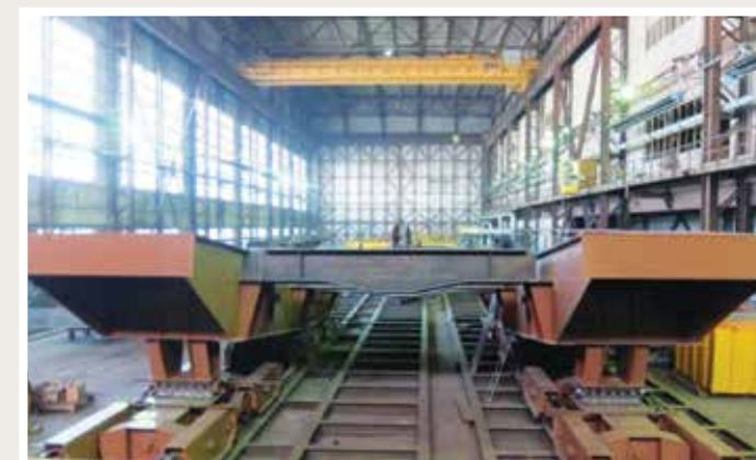
Рис. 11. Контрольная сборка продольных балок платформы между косяковыми тележками на балансирах с шаровыми опорами
